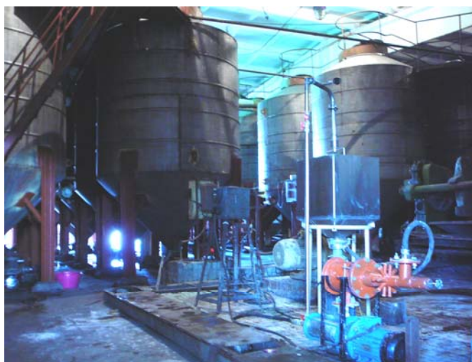
Рис. 2. Кавитационная трехчастотная установка в линии для приготовления вина
