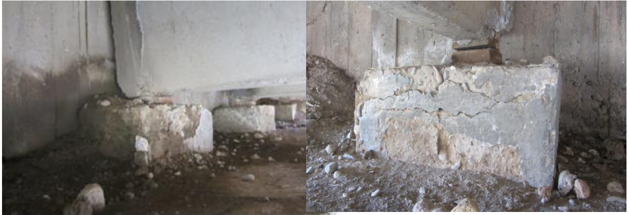
Фото 4. Разрушение опорных тумб опоры №1
