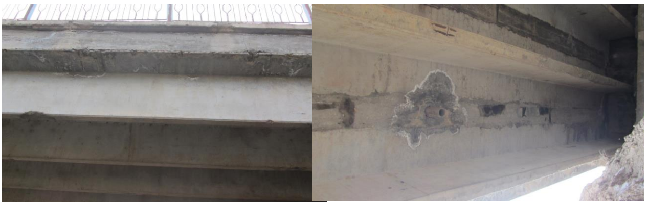
Фото 3. Коррозия бетона внешней консоли плиты и бетона омоноличивания
