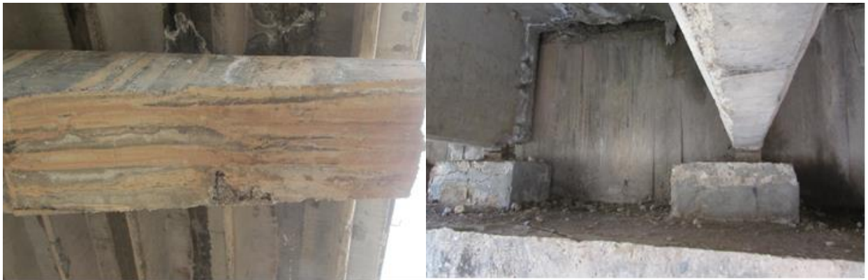
Фото 2. Следы выщелачивания и коррозии бетона на поверхности балок и опор
