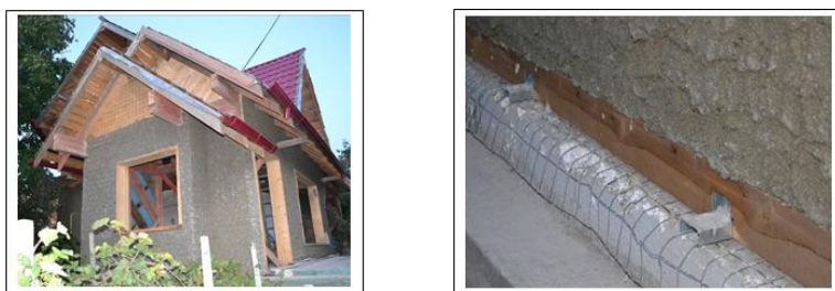
Fig. 10 – Detalii de execuție ai pereților exteriori și a zonelor de ventilare ale tălpii de fundare
