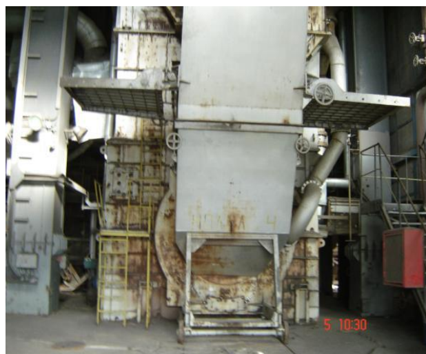
Fig. 1. Fan coal mill.
