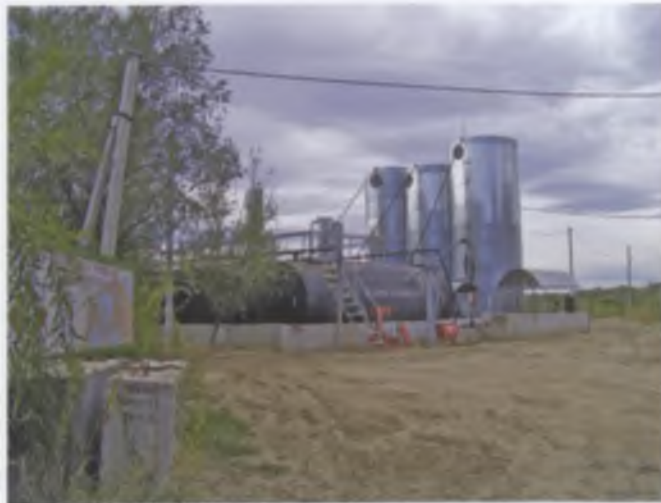
Foto 7. Rezervuare de păstrare a petrolului
