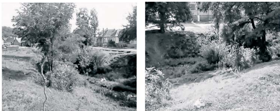
Fig. 5. Taluzurile îmbrăcate de vegetație deteriorată
